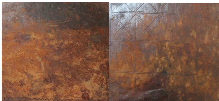
Degradări fizico-chimice (schimbarea culorii)
