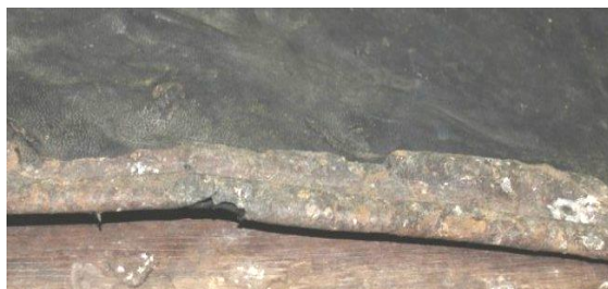
Degradări ale învelitorilor - deformare, rigidizare, desprinderi de pe scoarțe
