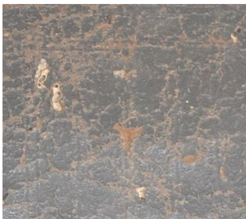
Desprinderi ale pielii, fisuri
